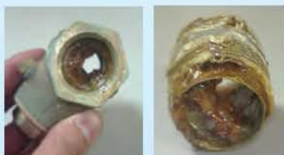
配管後15年経過 水道管内部状況
